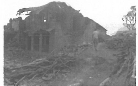
地震で大きく損壊した家屋（CODE撮影）
