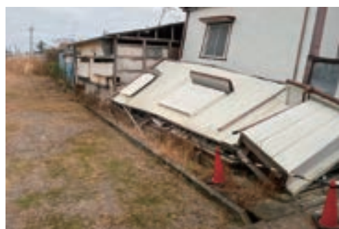
町内には崩れたままの家が残っている。
